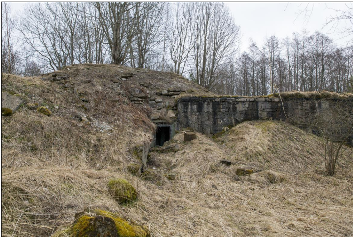
Foto 42 (602). Rohuneeme uuem raketibaas (S-125). Komandopunkt [4]. On toimunud mingid lammutustööd, avade ette on kuhjatud pinnast. Foto Mart Mõniste 5.04.2017
